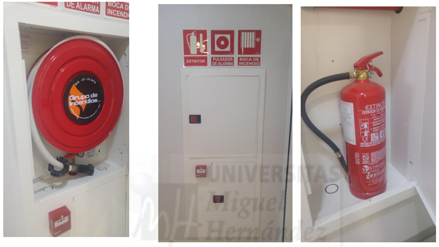
Equipos contra incendios. Fotos propias.
