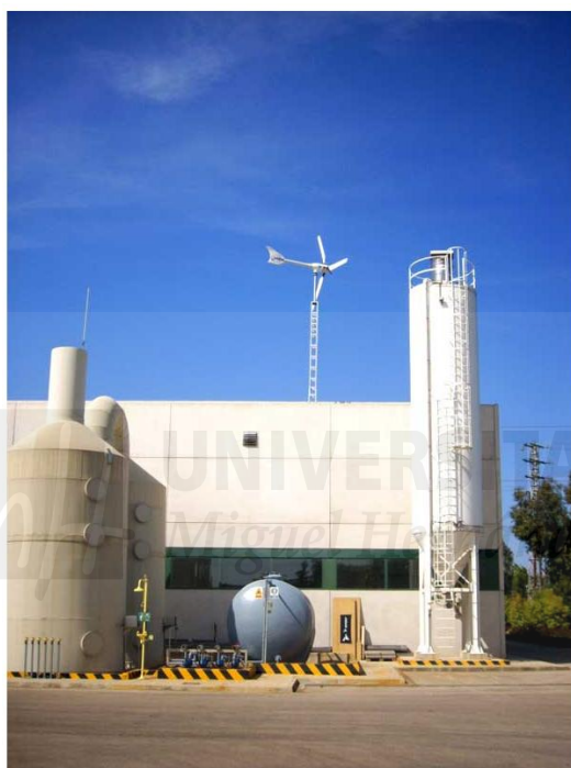
Aerogenerador en la EDAR de Paterna - Fuente del Jaro (Valencia) Suministro y puesta en marcha de aerogenerador de eje horizontal de 3,5 kW
