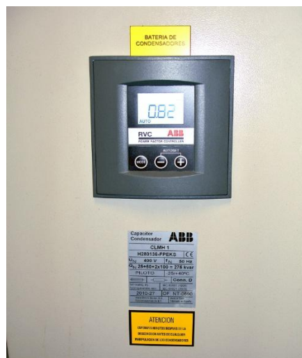
Figura 28. Ejemplo del cuadro de una batería de condensadores (Tessai, 2011).
