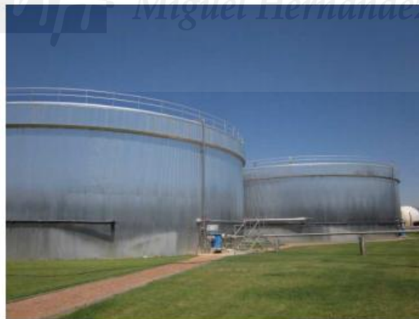
Figura 43. Digestores calorifugados en la EDAR Murcia Este (Murcia) (CONAMA, 2014).
