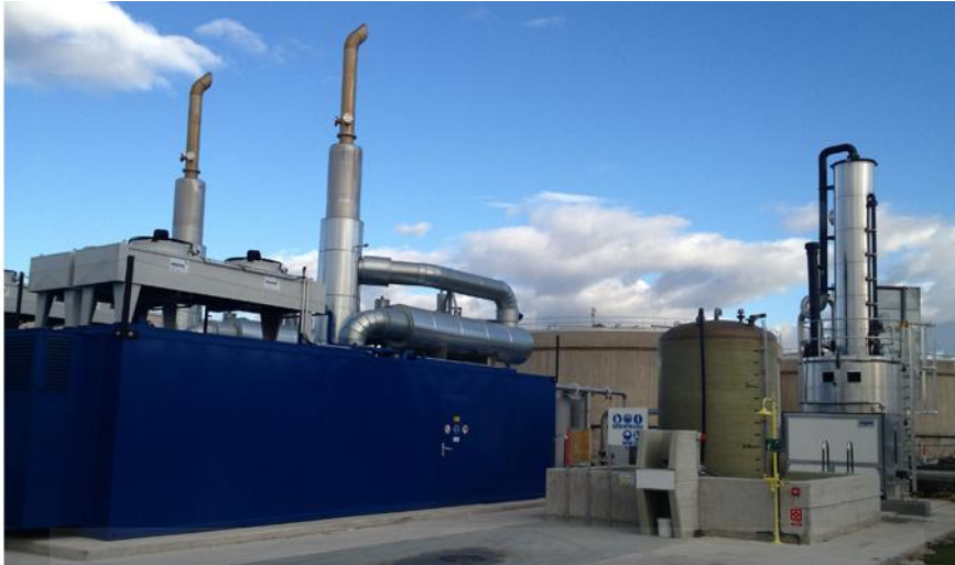
Figura 7. Planta de cogeneración de la EDAR Murcia Este (Murcia) (Schneider Electric, 2014).
