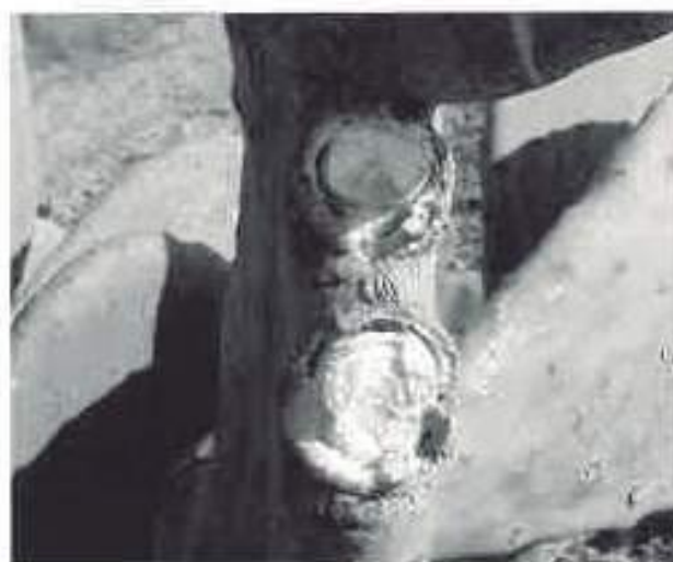
Fotografía 152. Detalle de corte de poda mal ejecutado.
