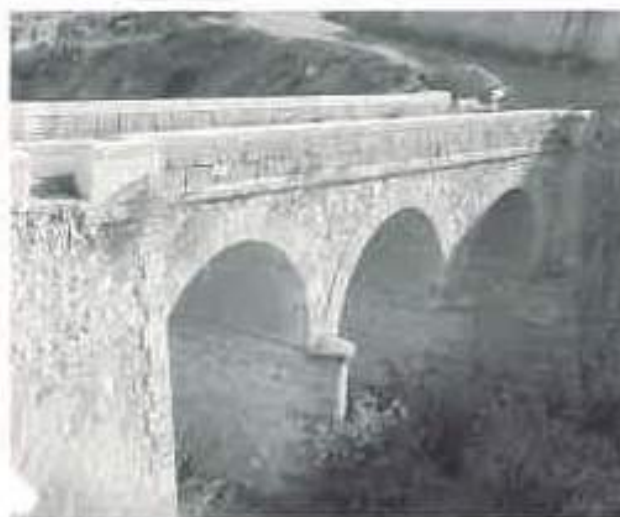
Fotografía 70. Crecimiento de alcaparra en el muro de un puente.
