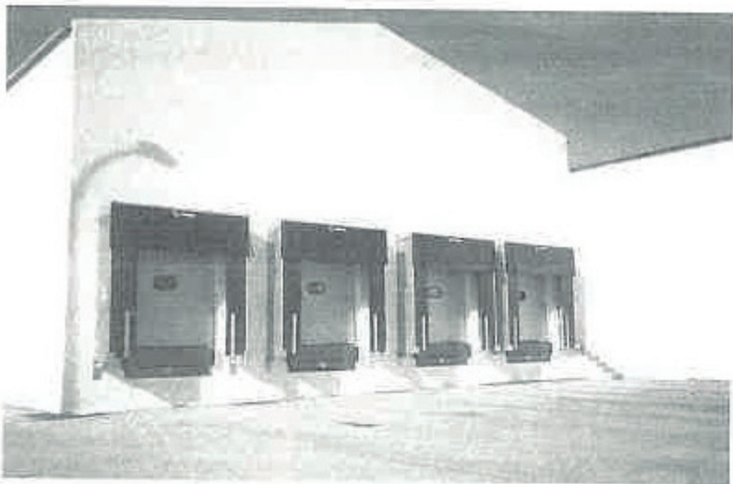
Foto. 15. Puertas de guillotina en abrigos de muelles de carga. Las plataformas de los muelles son de altura regulable.
