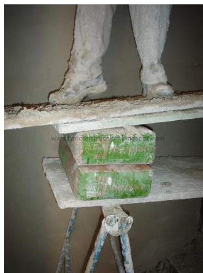
Imagen 44. Apoyo no permitido de la plataforma sobre sacos de yeso. ( www.tprl.com )
