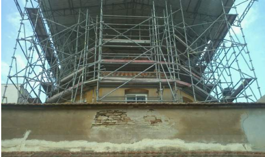
Imagen 147. Andamio instalado sobre azotea. ( www.construmatica.com )
