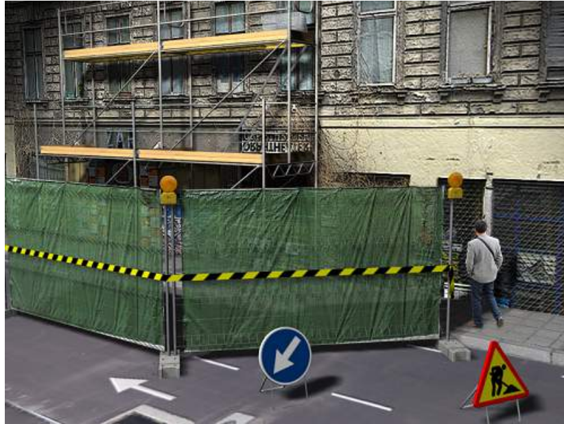
Imagen 32. Señalización de andamio en vía de circulación. (www.construmatica.com)
