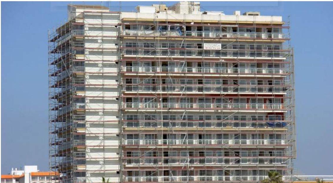
Imagen 8. Andamio tubular en fachada. (Autor)
