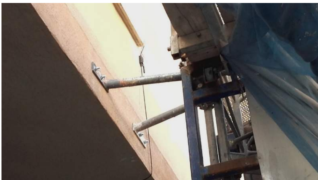
Imagen 24. Anclaje de andamio a fachada. Será necesario verificar el correcto estado de estos. (Autor)
