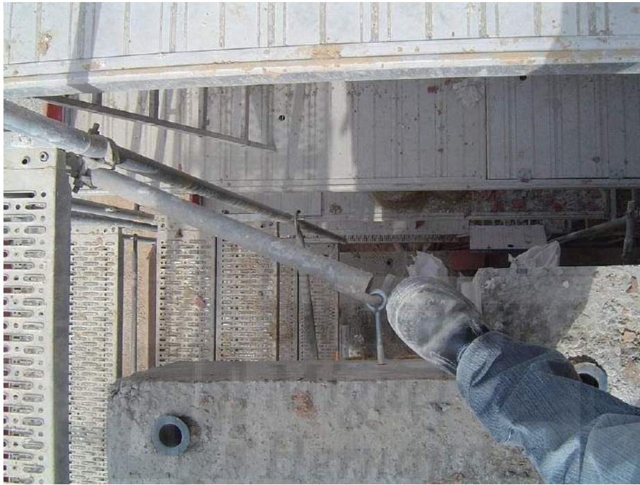
Imagen 30. Hueco peligroso desprotegido entre andamio y forjado. (Autor)
