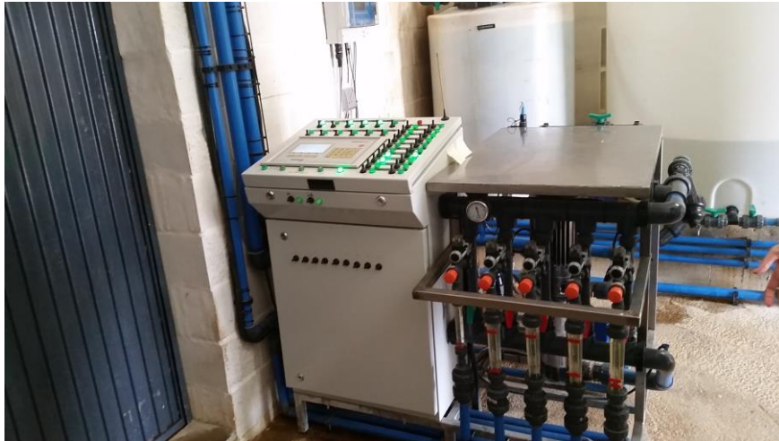
Control del sistema de riego
