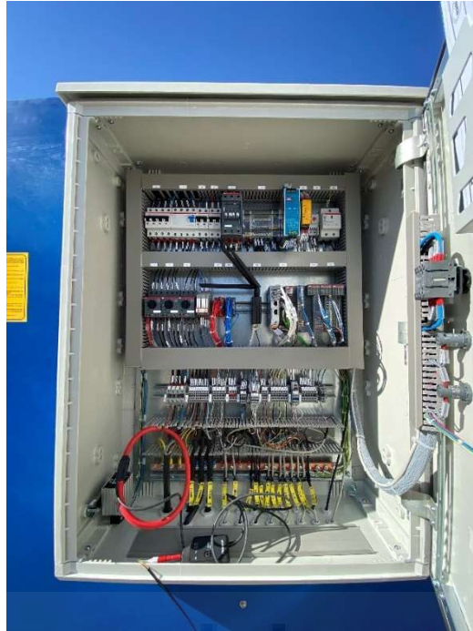
Figura 4.9: Toroide midiendo la corriente de alimentación a los ventiladores.
