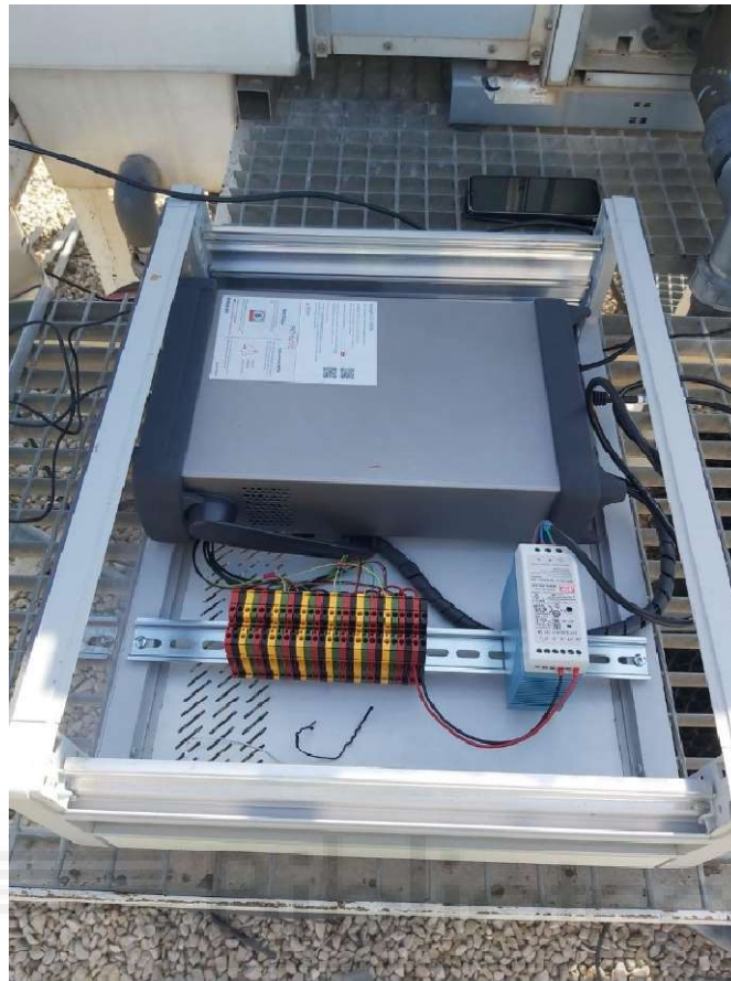
Figura 3.1: Unidad portátil de conexionado del sistema de monitorización.
