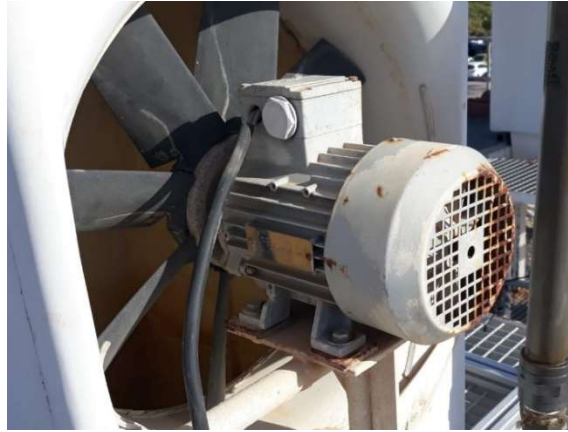
Figura 6. Ventilador de la instalación Siemens
