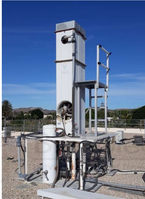
Figura 4. Torre de refrigeración de la instalación
