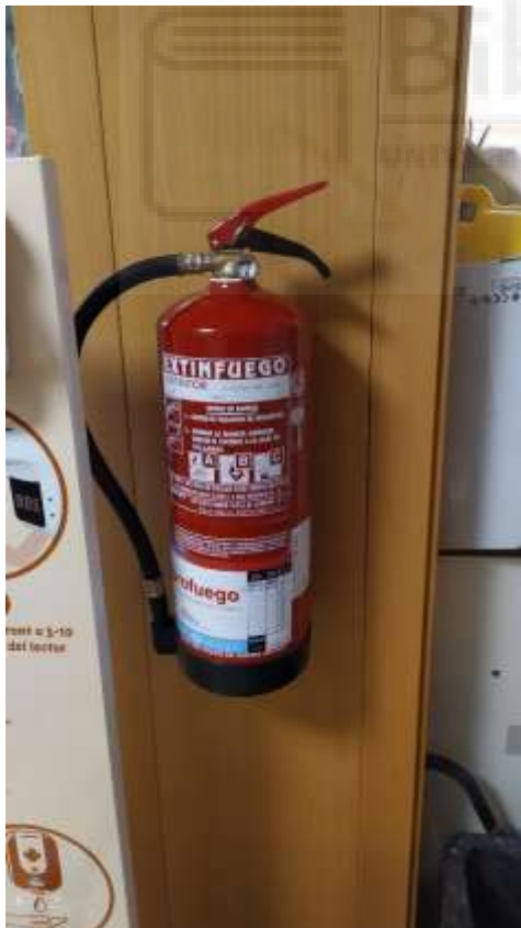
IMAGEN 12: Extintor de polvo ABC
