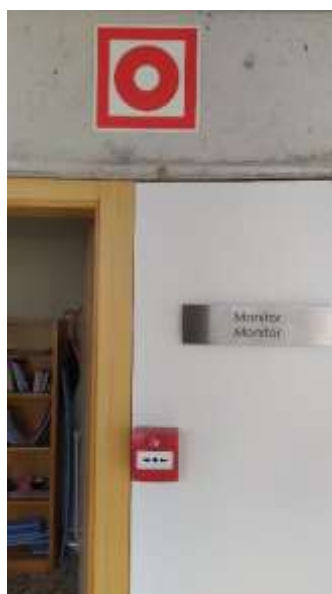
IMAGEN 11: Pulsador de alarma
