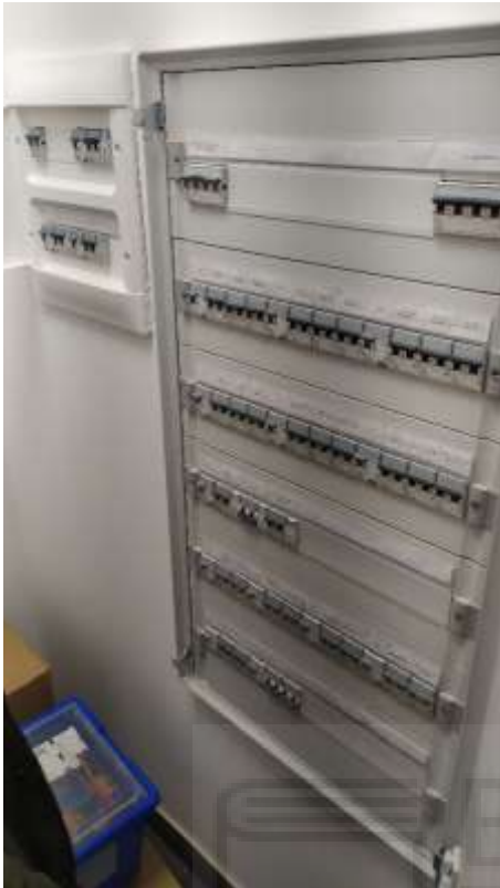
IMAGEN 9: Cuadro eléctrico principal
