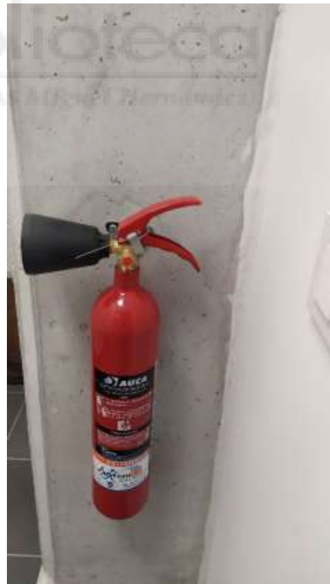
IMAGEN 13: Extintor de CO2
