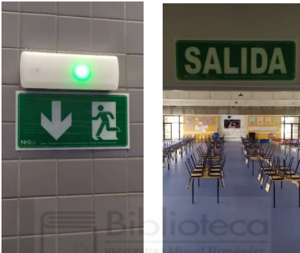
IMAGEN 15: Alumbrado de emergencia y señalización de evacuación
