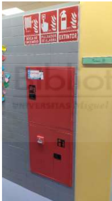
IMAGEN 14: Boca de Incendio Equipada (BIE)
