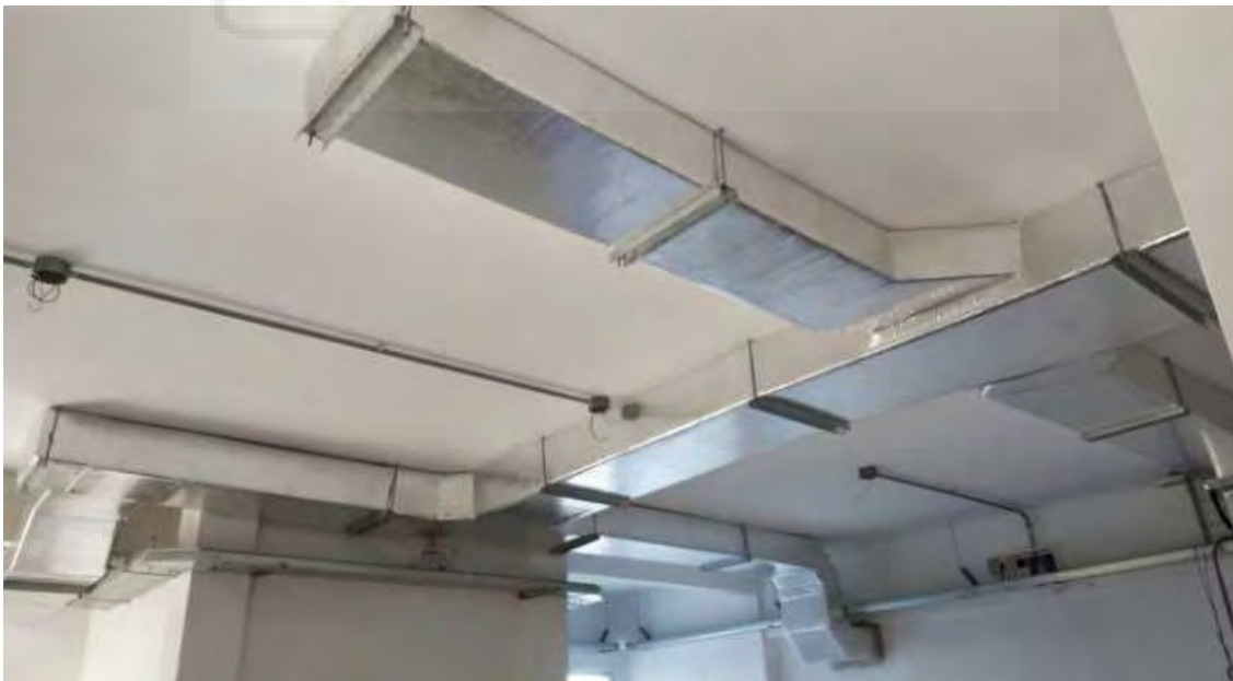
Imagen 5. Sistema de ventilación por conductor rectangulares.
