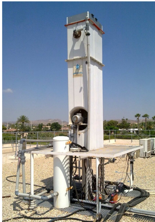
Figura 3: Torre de refrigeración experimental.
