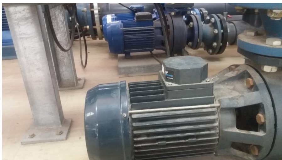
Figura 15. Bombas de la instalación.
