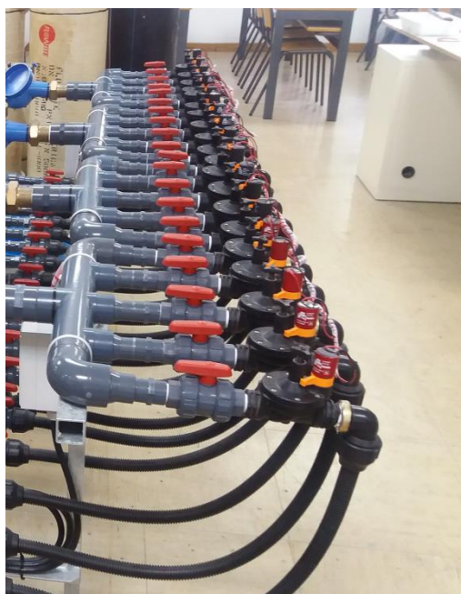
Figura 24. Electroválvulas de la instalación.
