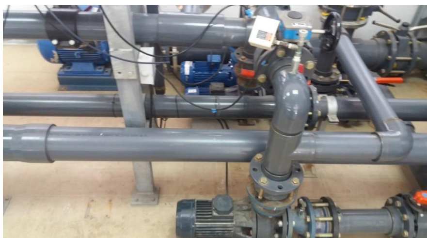
Figura 14. Sistema de bombeo del banco de ensayos de material de riego.
