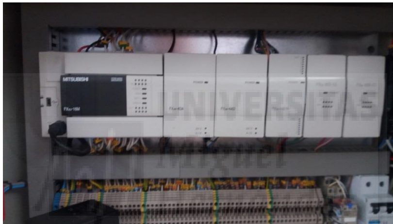
Figura 26. Controlador lógico programable de la instalación.
