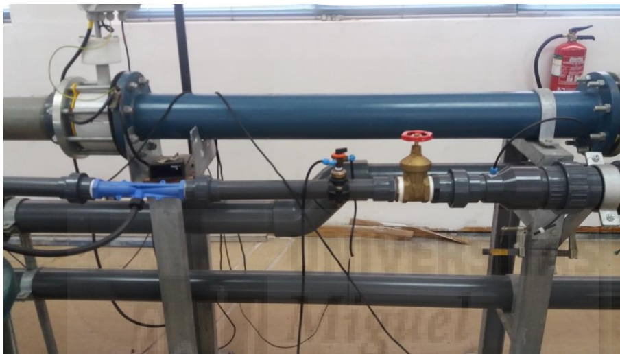
Figura 19. Tuberías del banco de ensayos.
