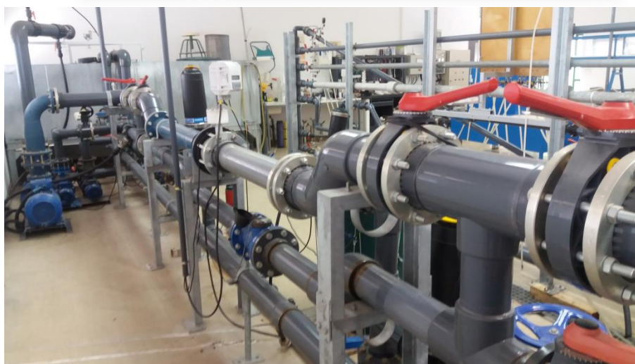
Figura 25. Accesorios de la red de distribución de riego del banco de ensayos.
