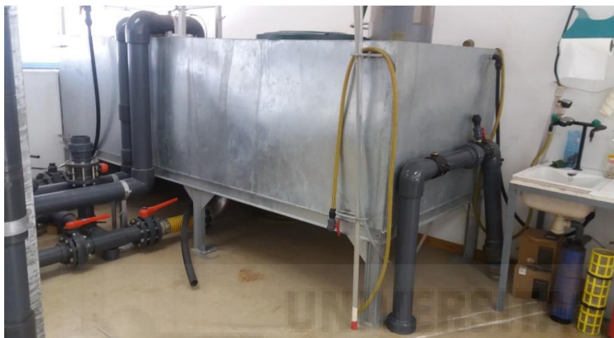
Figura 13. Depósito de agua del banco de ensayos de material de riego.
