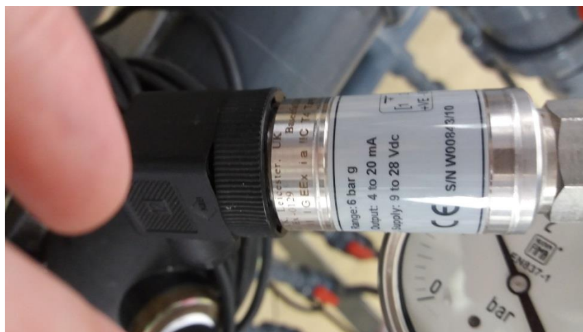
Figura 30. Transducción de presión ubicada en el inicio de la red colectiva de riego.
