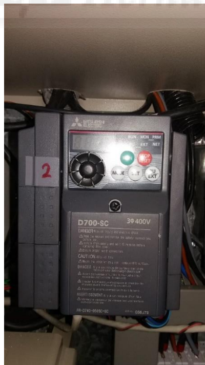
Figura 32. Variador de frecuencia del banco de ensayos.
