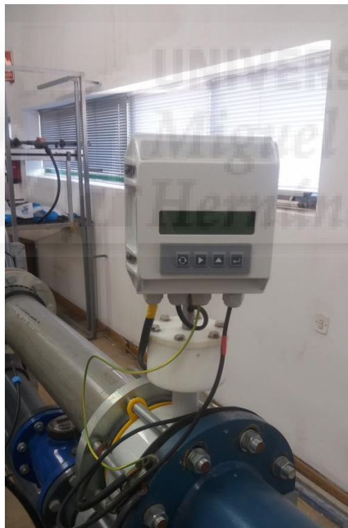
Figura 31. Caudalímetro electromagnético, situado en el bypass del banco de ensayos.
