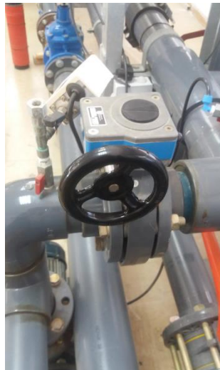
Fotografía 20. Válvula manoreductora instalada en la tubería de impulsión de la bomba 3.
