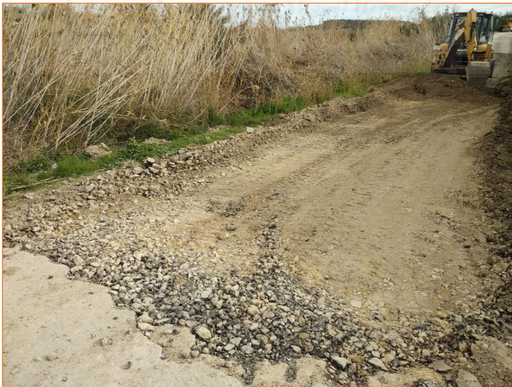
ILUSTRACIÓN 8. DEMOLICIÓN DE PAVIMENTO EXISTENTE EN MAL ESTADO PARA LA EJECUCIÓN DE BADÉN MEDIANTE HOMIGÓN HIDRÁULICO EN CAMINOS RURALES (FUENTE: ELABORACIÓN PROPIA)
