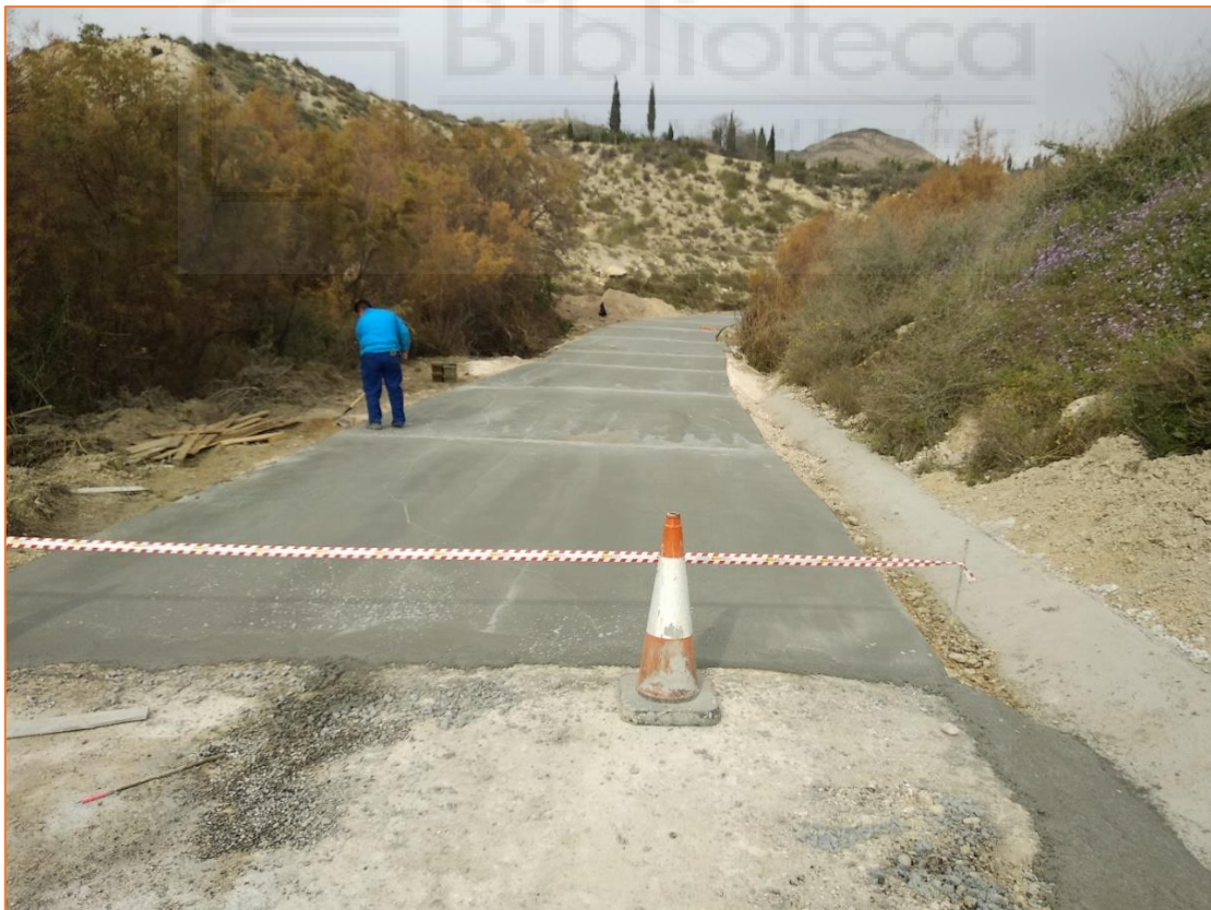
ILUSTRACIÓN 5. EJECUCIÓN DE BADEN MEDIANTE HORMIGÓN HIDRAULICO EN CAMINO RURAL (FUENTE: ELABORACIÓN PROPIA)
