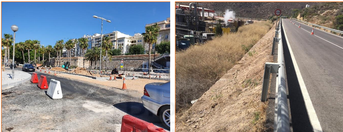
ILUSTRACIÓN 11. EJEMPLO DE CORTES PARCIALES O TOTALES EN OBRAS DE CONSERVACIÓN DE CARRETERAS (FUENTE: ELABORACIÓN PROPIA)
