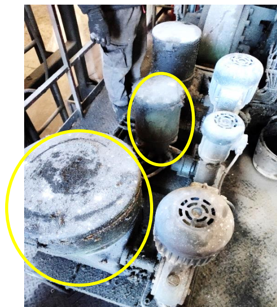
ILUSTRACIÓN 17: DEPÓSITOS DE GRASA
