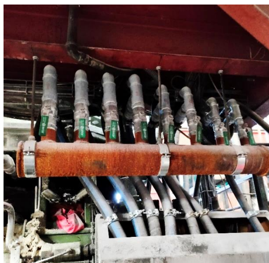
ILUSTRACIÓN 19: SISTEMA DE REFRIGERACIÓN
