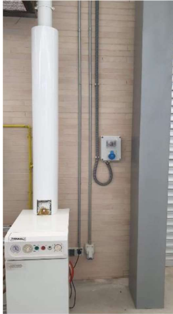
Figura 27. Caja de suministro fotovoltaico.
