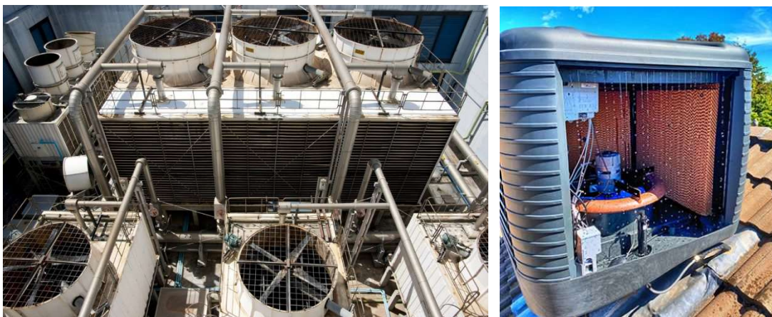
Figura 4. Torres de refrigeración y paneles evaporativos.
