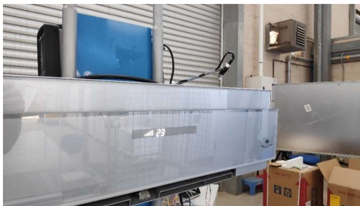
Figura 30. Emisor LED KY-005 del sistema de control remoto sobre el split.
