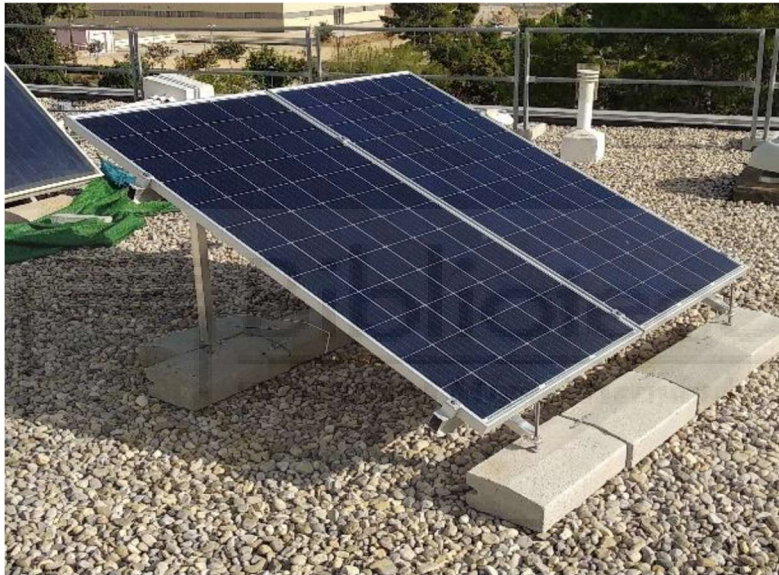
Figura 26. Paneles fotovoltaicos, azotea edificio Altet.
