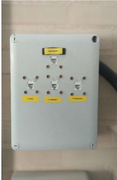
Figura 29. Caja de conexiones rápidas.
