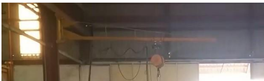
Figura 102. Grúas pluma existentes en la planta
