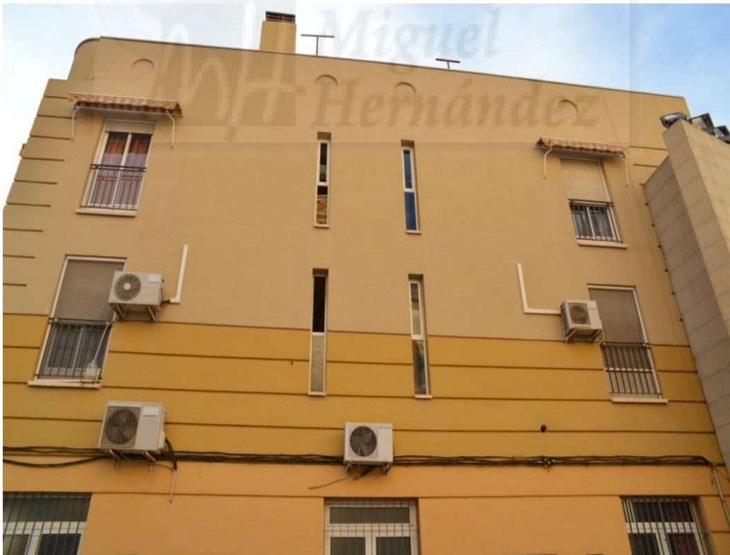
Fotografía 120. Estado de fachada frente a la Iglesia del Colegio Santo Domingo (BIC) y próxima a Casa de Miguel Hernández en Centro Histórico de Orihuela. Diciembre 2014. Obsérvense los cables y los aparatos de aire acondicionado.
