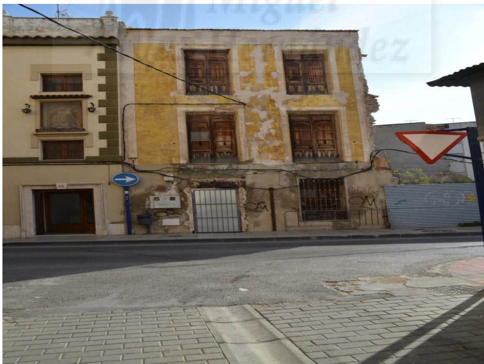
Fotografía 104. Mal estado de casa en Calle San Juan, aldaña al Centro Histórico. Diciembre 2014.
