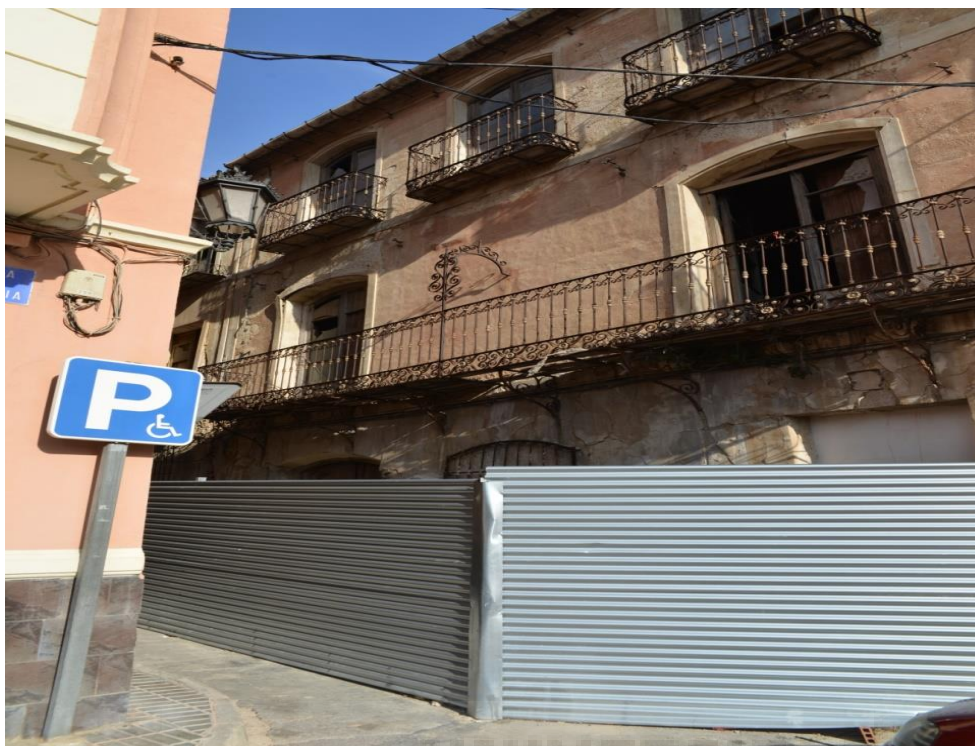
Fotografía 103. Mal estado de vivienda en la Calle Santacruz, frente a Plaza de Santa Lucía, pleno Centro Histórico. Diciembre 2014.
