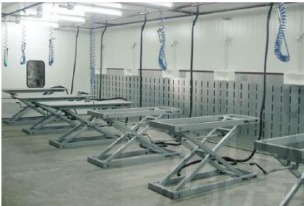
Cabinas de extracción con ventilación forzada, extraído de Aspiraciones Perca, 2011 [28]
