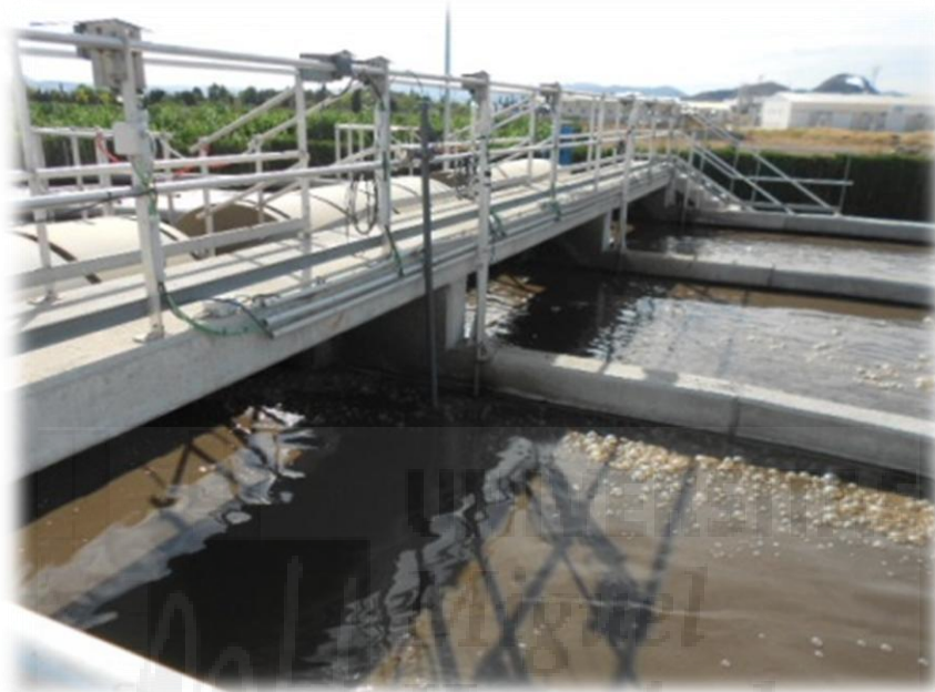
Figura 9: Canales de Oxidación
