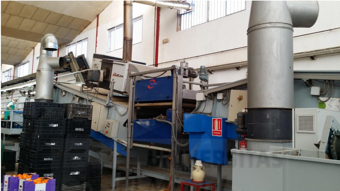
Figura 14. Máquina de lavado, presecado, encerado y secado (elaboración propia).
