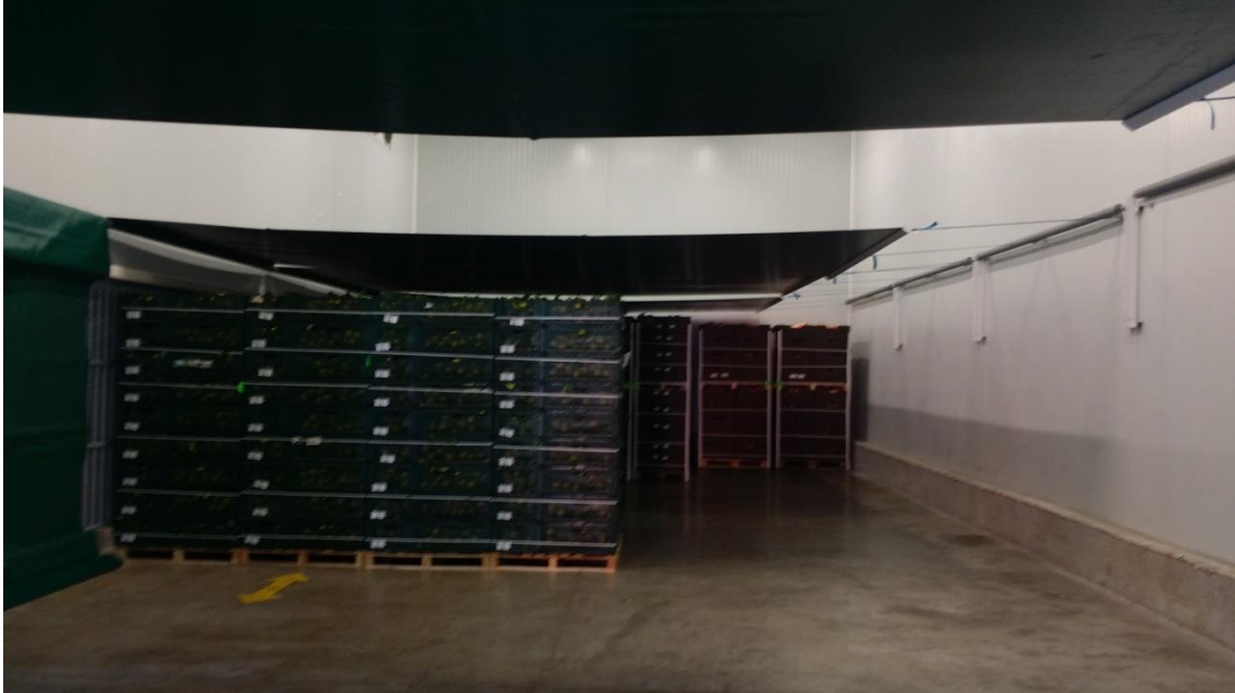
Figura 21. Cámara frigorífica túnel de frío (elaboración propia).
