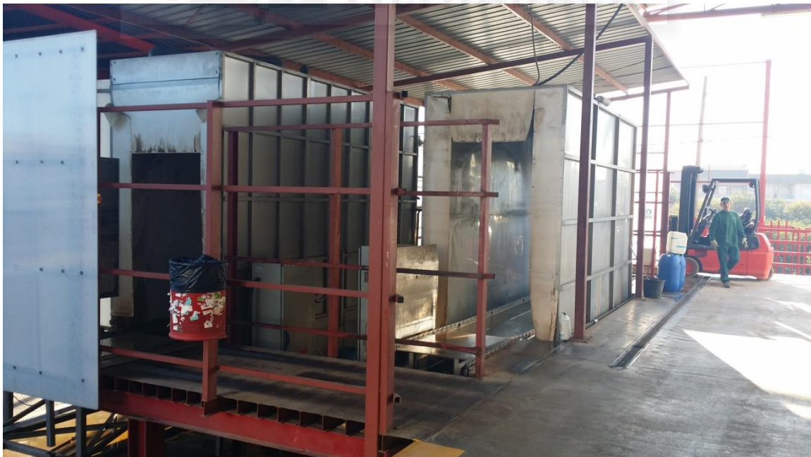
Figura 11. Drencher (elaboración propia).
