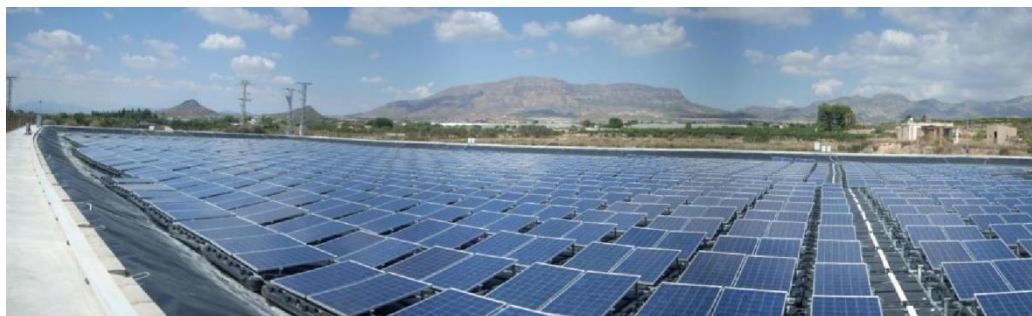
Figura 321. Posible autoconsumo sobre una balsa de una red de riego, sin necesidad de suministro de la red de distribución.
