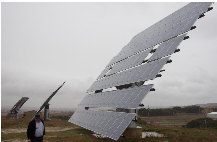
Fotografía 51. Panel fotovoltaico con seguidor astronómico. Albacete. Fuente propia.
