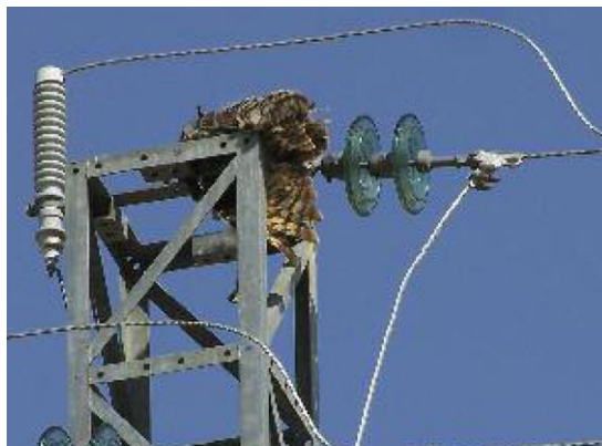
Fotografía 23. Electrocción de un ave con un apoyo eléctrico de alta tensión. [378]
