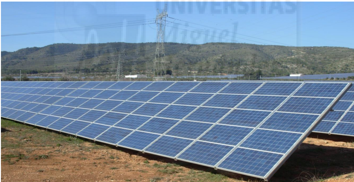
Fotografía 49. Central fotovoltaica de Benexama 20 MW. Alicante. Comunidad Valenciana. Fuente propia.
