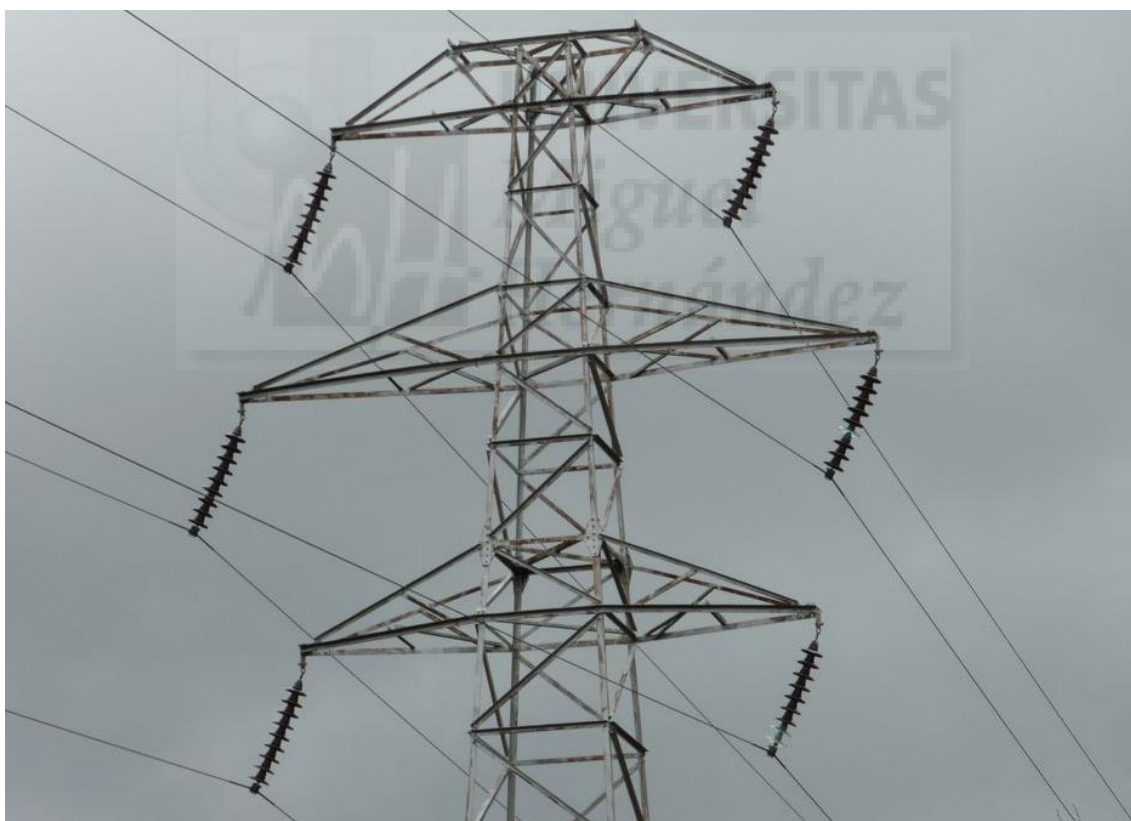
Fotografía 37. Efecto del viento en los conductores de una línea aérea de alta tensión. Fuente propia.
