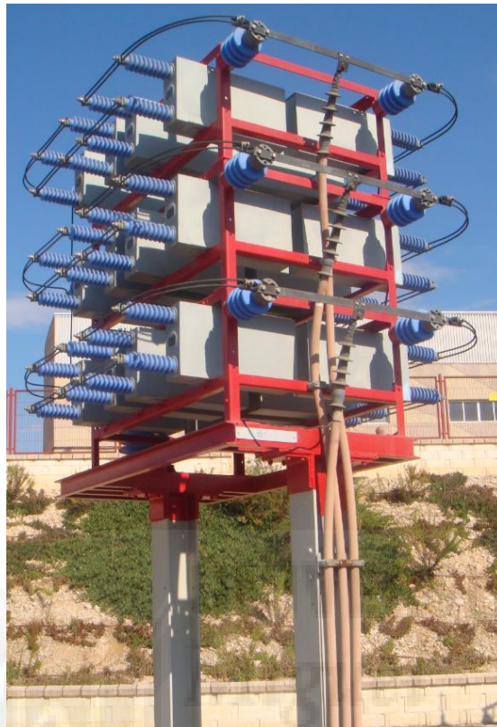
Fotografía 18. Condensadores en Subestación. 20 kV. Fuente propia.
