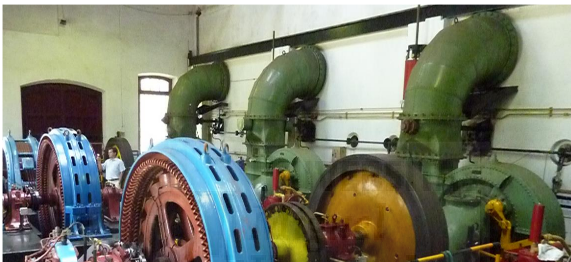
Fotografía 9. Central mini hidráulica Hidrocantábrico. Fuente propia.
