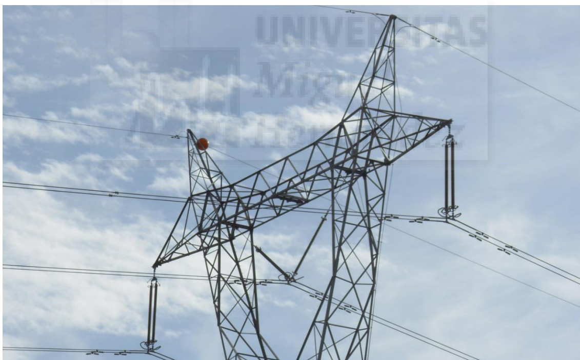
Fotografía 24. Baliza de señalización. No tiene nada que ver con la avifauna. Se utiliza para los vuelos en helicóptero en los apoyos terminados en 0 y 5 por REE. Fuente propia.
