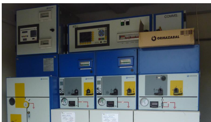
Fotografía 34. Centro de transformación motorizado y con "remota". Fuente propia.
