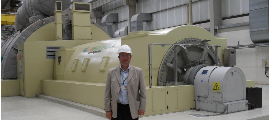
Fotografía 3. Generador de la Central eléctrica de Iberdrola de Ciclo Combinado de gas natural, en Cartagena. Fuente propia.
