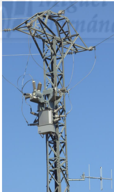
Fotografía 20. Interruptor automático telemandado. Fuente propia.
