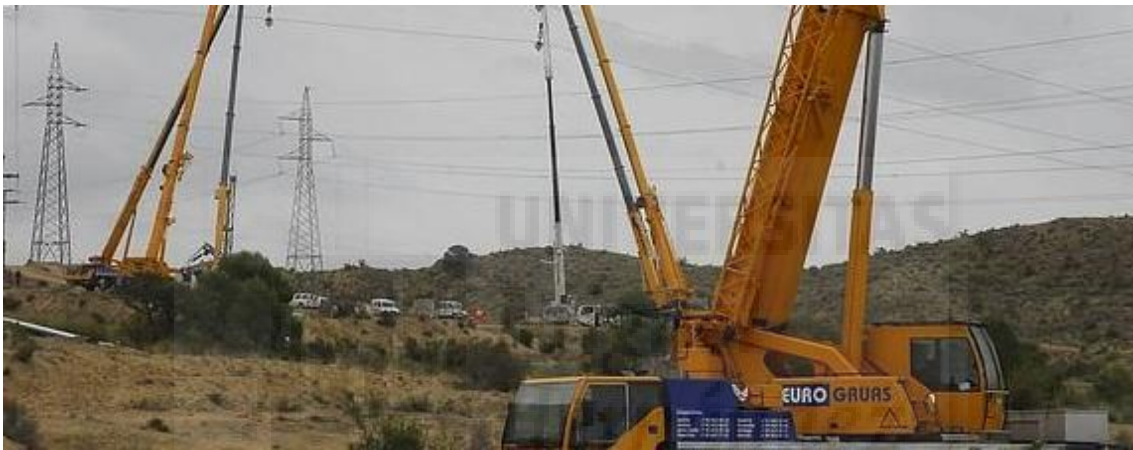
Fotografía 1. Apagón eléctrico ocurrido en la subestación de Jijona (Alicante) en junio de 1999. [1]
