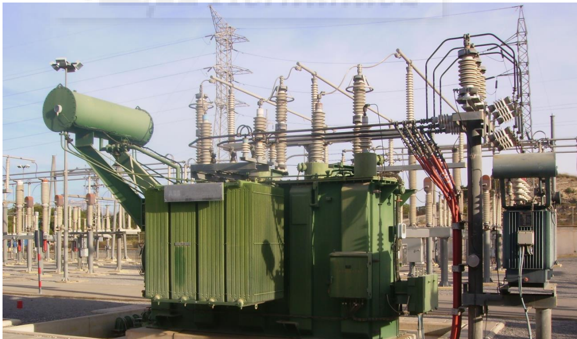
Fotografía 19. Reactancia homopolar en transformador de potencia. Fuente propia.
