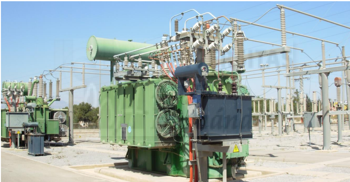
Fotografía 6. Subestación de distribución de Iberdrola (Alicante). Fuente propia.
