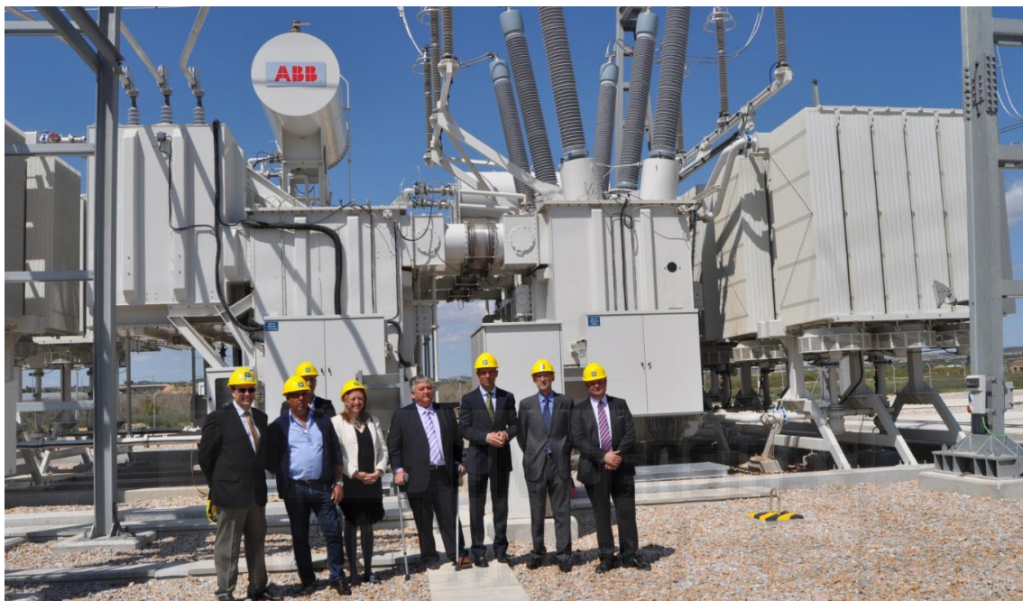
Fotografía 21. Transformador desfasador en San Miguel de Salinas, Alicante, Comunidad Valenciana. Fuente propia.
