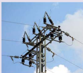
Seccionadores e interruptores
