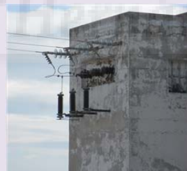
Caseta de transformación
