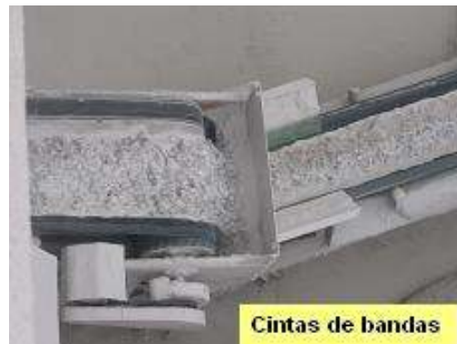
Fotografía 4. Cinta transportadora de bandas. (Fuente Algiss).
