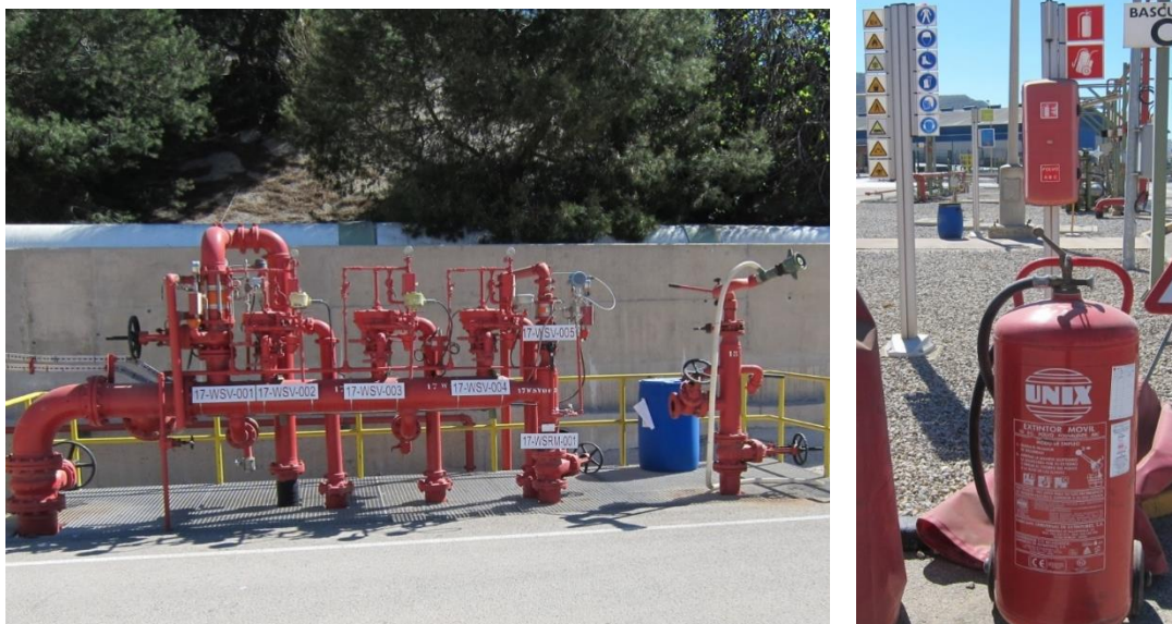
Ilustración 14. Medios contra incendios existentes en la zona
