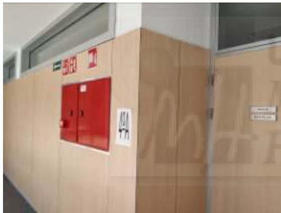
IMAGEN 78: Señales extintores y BIEs
