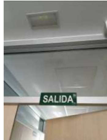
IMAGEN 78: Luces de emergencia
