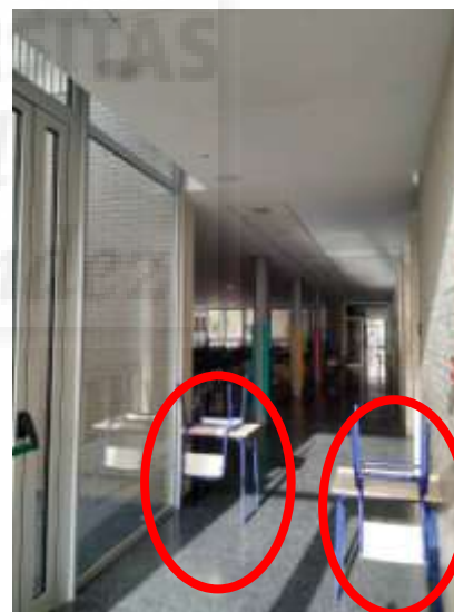
IMAGEN 84: Camino de evacuación ocupado por dos pupitres.
