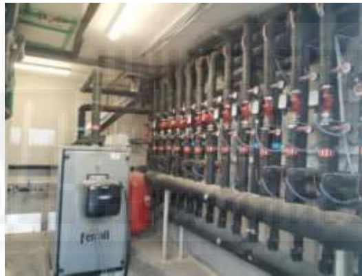
IMAGEN 20: Sala de Calderas Bloque 3
