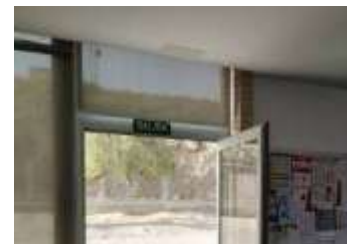
IMAGEN 37: Luz de emergencia
