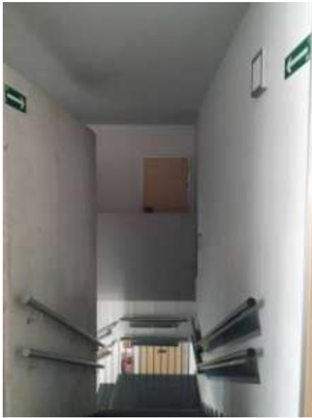
IMAGEN 85: Escaleras del Bloque 3 con señales actuales.
