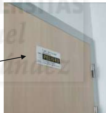
IMAGEN 23: Señal sala de máquinas de ascensor.
