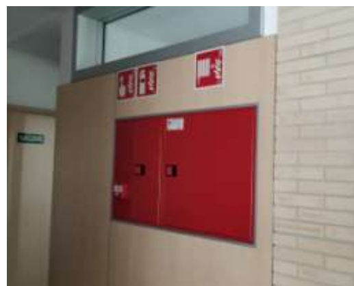
IMAGEN 39: BIE, pulsador, extintor
