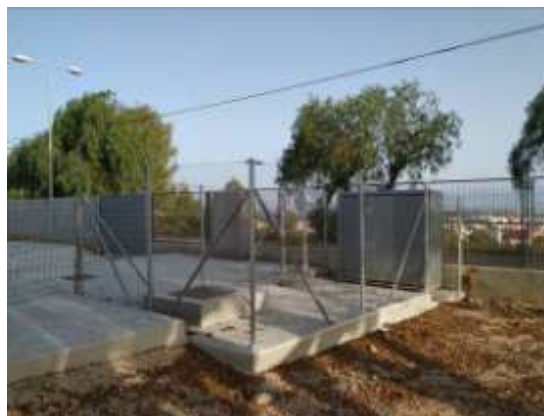
IMAGEN 25: Depósito de gasoil y almacén de botellas de propano.
