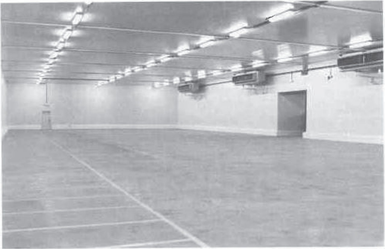
Foto 29. Interior de cámara frigorífica para conservación de productos refrigerados. Realización de Ingeniería del Frío, S.A. (INFRISA)
