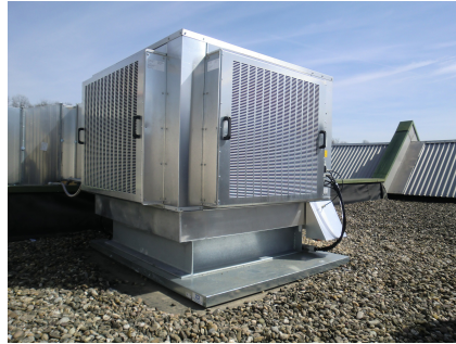
(b) Paneles de enfriamiento evaporativo
