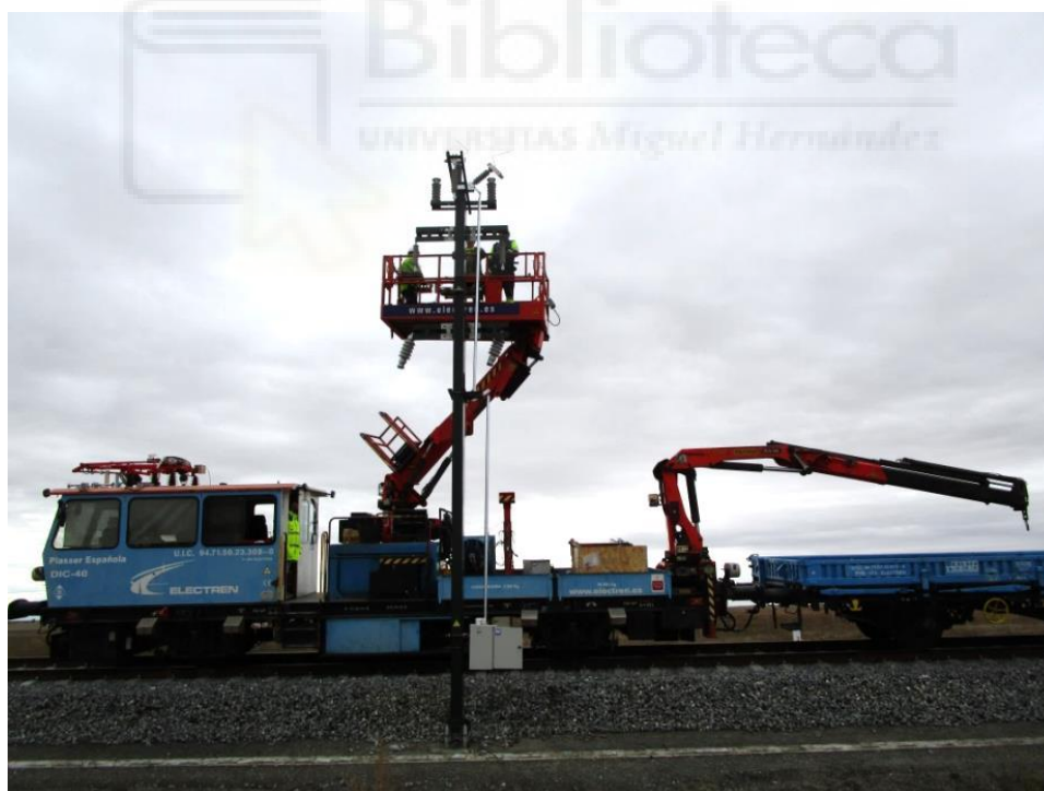
Figura 24. Regulación de seccionador
