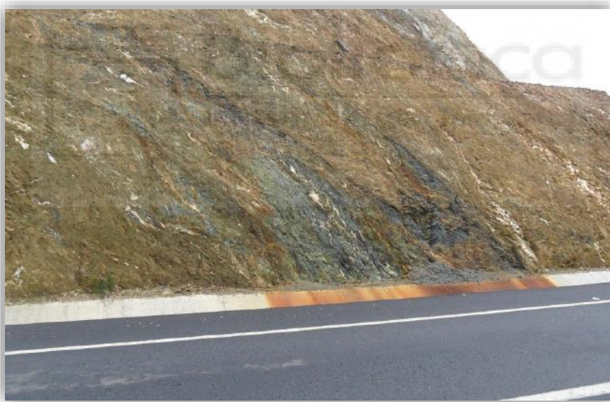
Figura 6. Oxidación de sulfuros en taludes de la autovía de Santiago a Orense (Fuente: Bolaños, 2014).
