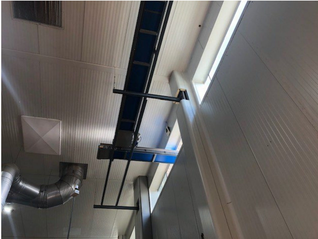
Figura 52. Cinta transportadora elevada y tramo de salida al exterior.
