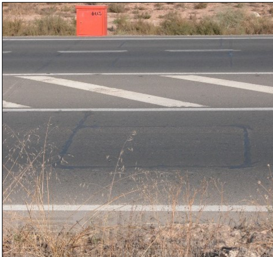
Figura 16 - Espiras instaladas la vía para el contabilizado de vehículos.
