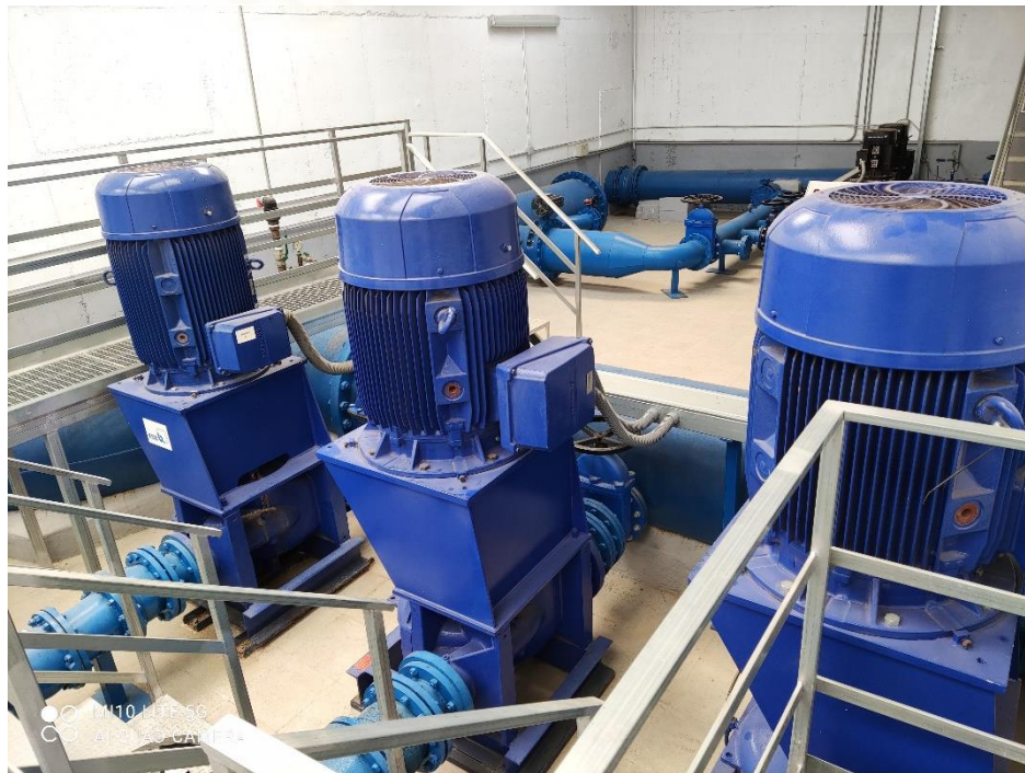
Figura 2.3. Bombas de T2
