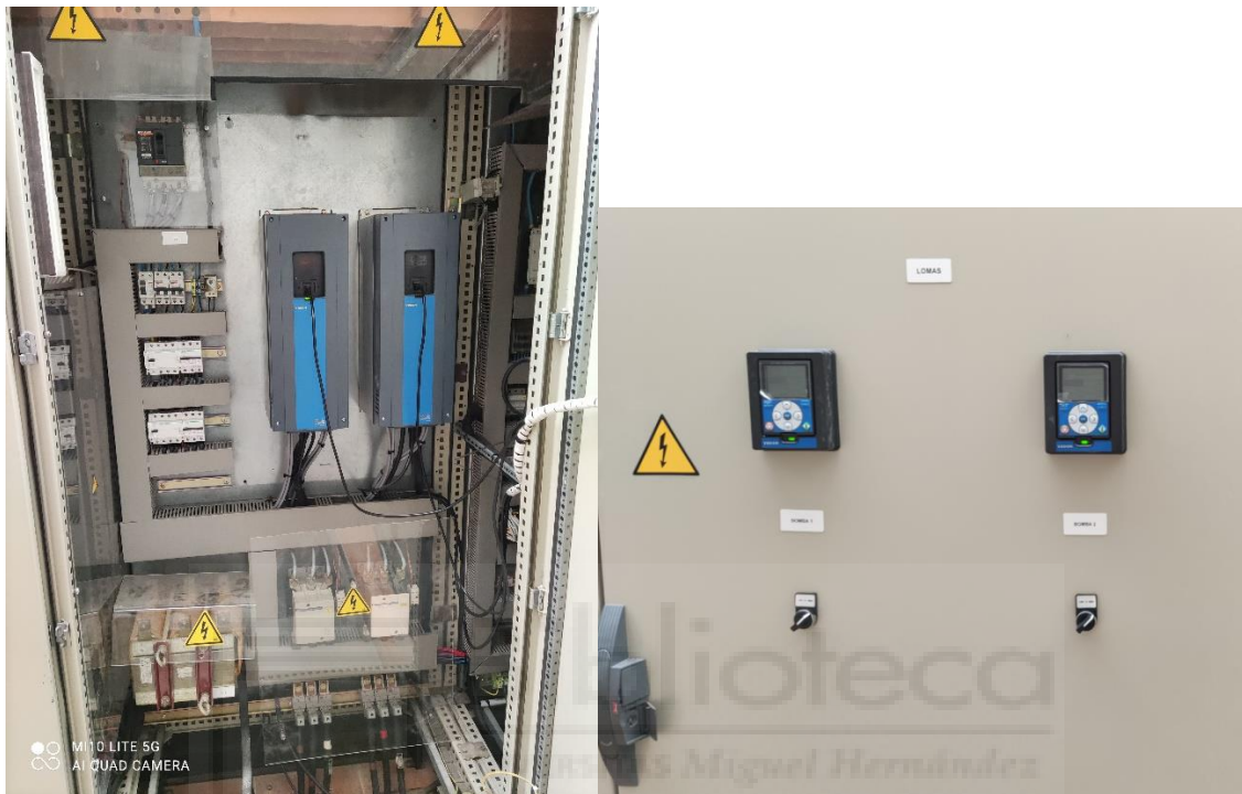
Figura 2.4. Cuadro eléctrico de Lomas
