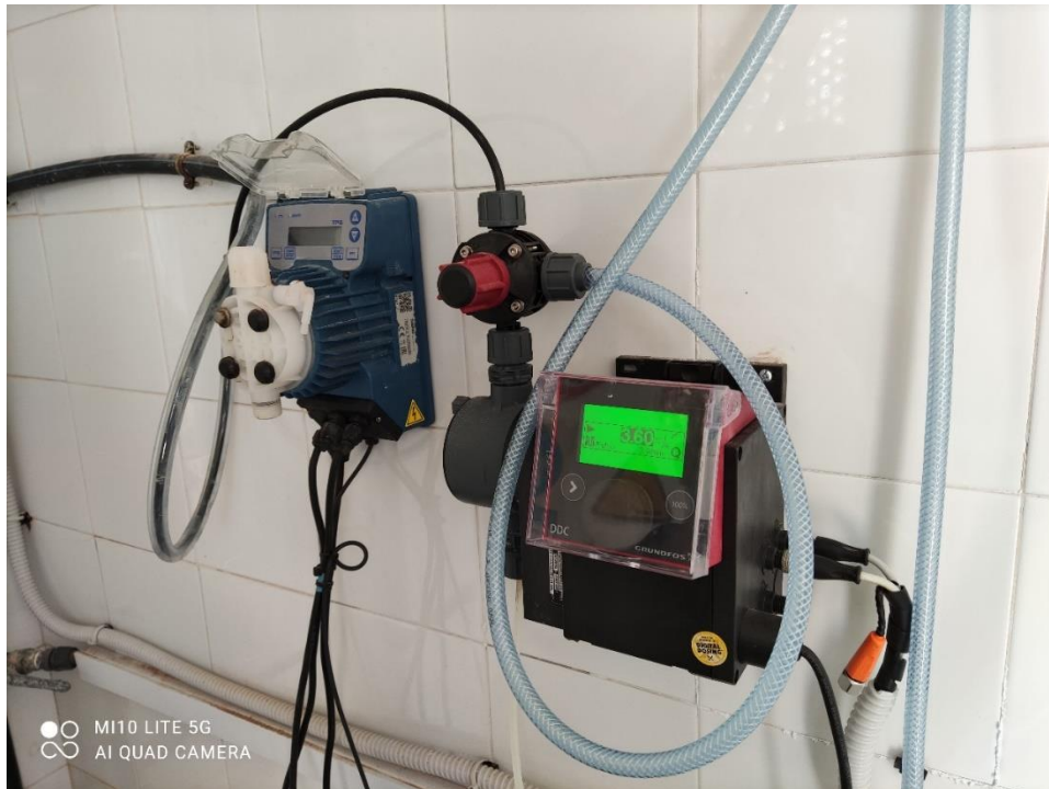
Figura 2.8. Bomba de cloro antigua (izquierda) y nueva (derecha)
