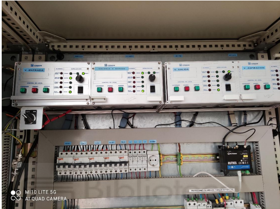
Figura 2.19. Cuadros de maniobra de las válvulas
