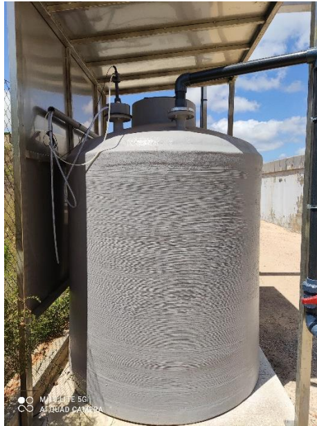
Figura 2.6. Depósito de cloro
