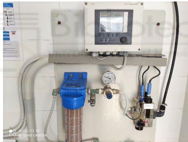
Figura 2.7. Analizador de cloro
