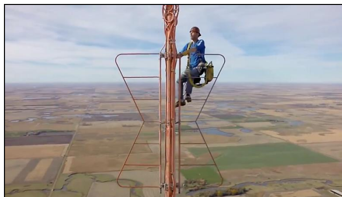
Trabajador ascendiendo por una escala en una torreta de telecomunicaciones. Imagen tomada con un dron.
